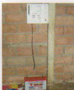
สภาพการติดตั้ง ใช้งานจริง
